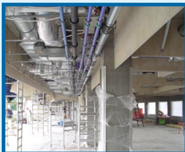
Veel installaties, geen punt.
