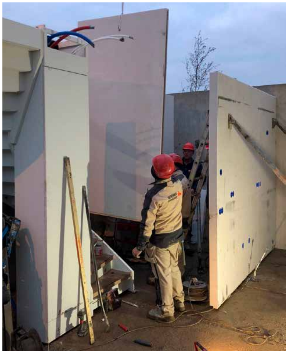
DE KINGSIZE WANDPANELEN KUNNEN ZO OP DE BOUWPLAATS IN HET WERK WORDEN GEHESEN.
